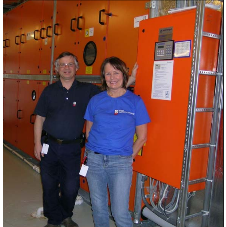
På bildet ser vi teknisk driftsleder Knut Bjerke og Driftsleder Inger C. Bagle foran et av avfuktingsaggregatene.
