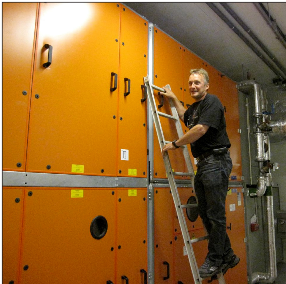
Tekniske rom har god plass og stor takhøyde, men det er også nødvendig når aggregatene er så store som her. På bildet ser vi teknisk sjefTrond Thorsen foran det ene aggregatet av type 373611 på 36.000 m 3 /h.
