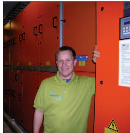
Børge foran Menerga avfuktingsaggregat.
